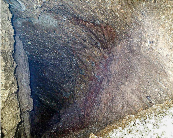
Ortsbrustversagen in nachbrüchigen Kiesen bei Drucklufteinstieg
